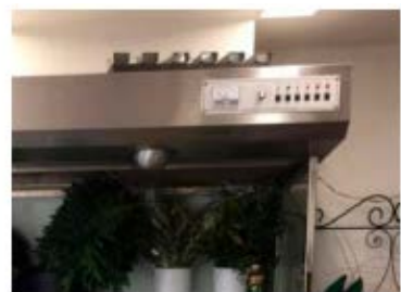
上部に位置する電気設備
